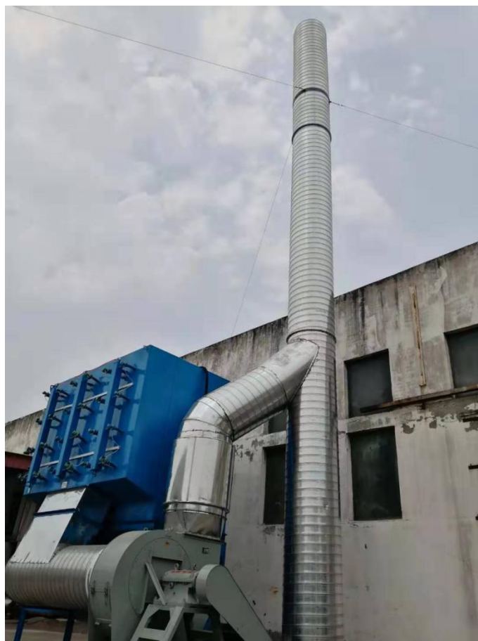
图 3-1 除尘器和排气筒
